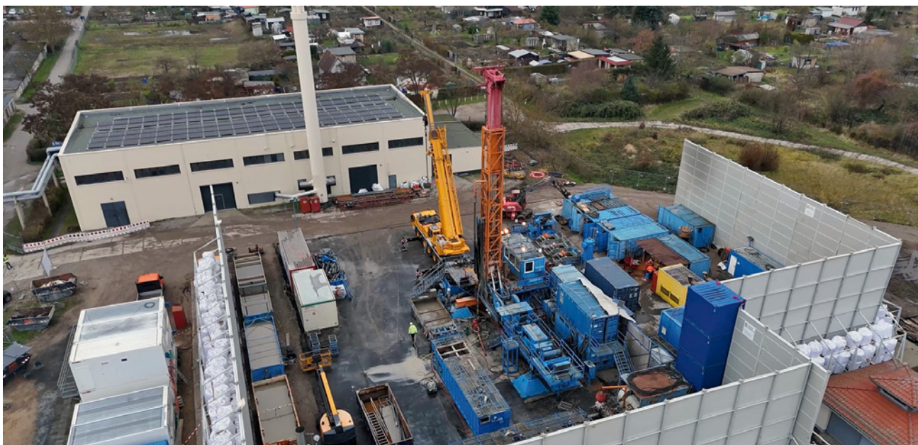
Abb. 5 Energie-Zentrale und Bohrplatz Gt Pr 4 am Thomas-Müntzer-Platz in Prenzlau
